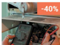
Contrôles réglementaires & sécurité incendie
